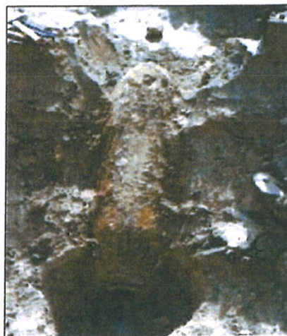
Abb. 1. Fliegerbombe, angetroffen bei Bauarbeiten in der Nähe einer Tankstelle
