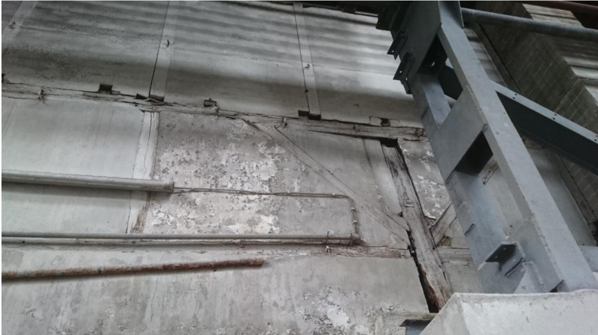
Abb. 12: Gebäude A, Innenraum, Spalten an Balken
