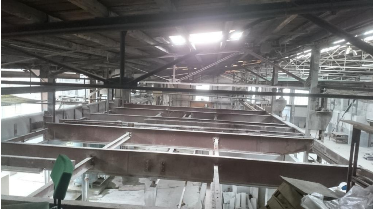
Abb. 1: Gebäude B, Dachkonstruktion Haupthalle; Spalten über Dachbalken
