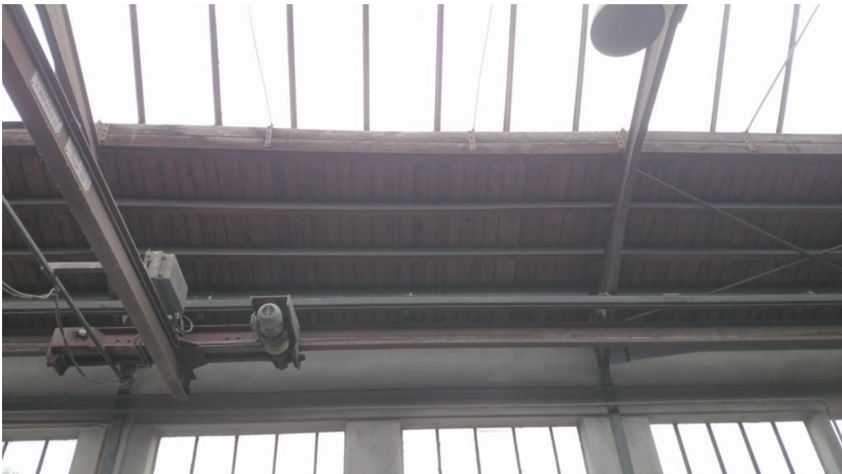
Abb. 15: Gebäude B, Dachkonstruktion südl. Gebäudeteil; Spalten über Dachbalken und Trägern
