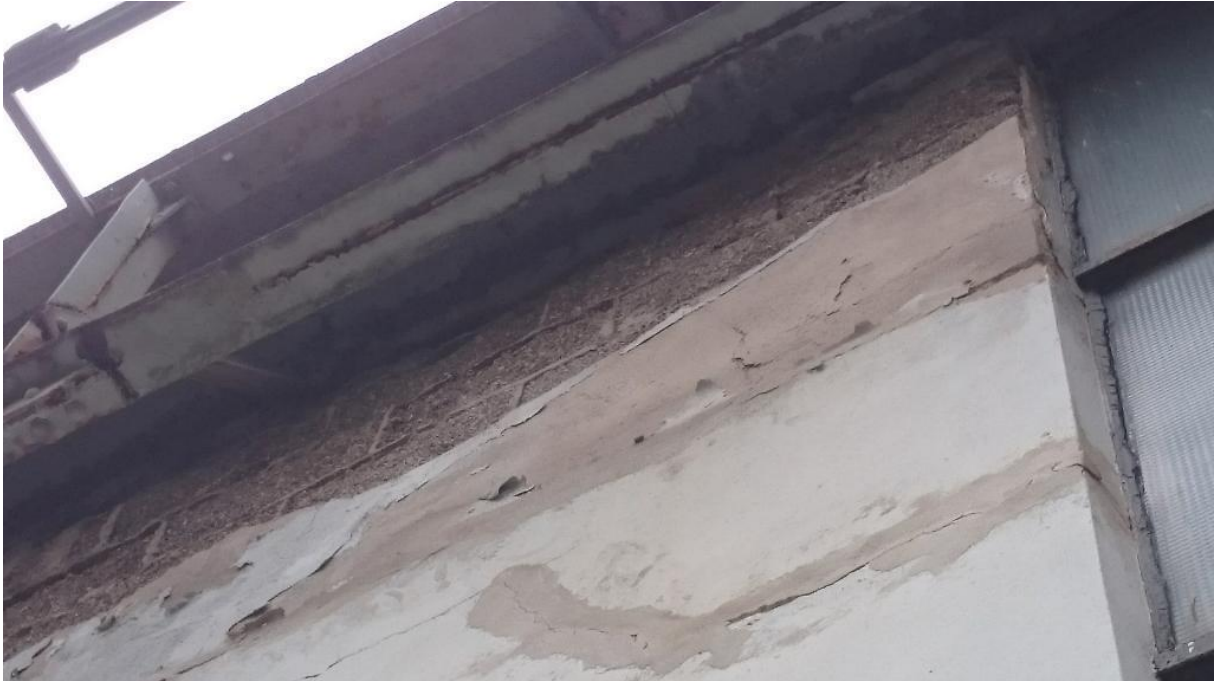
Abb. 10: Gebäude A, westl. Fassade mit Spalten über Hohlblocksteinen, abbröckelnder Putz
