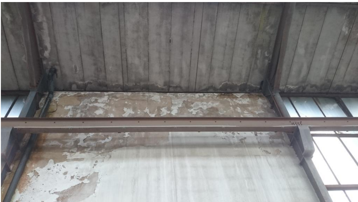
Abb. 11: Gebäude A, Innenraum: Spalten zwischen Decke und Wand
