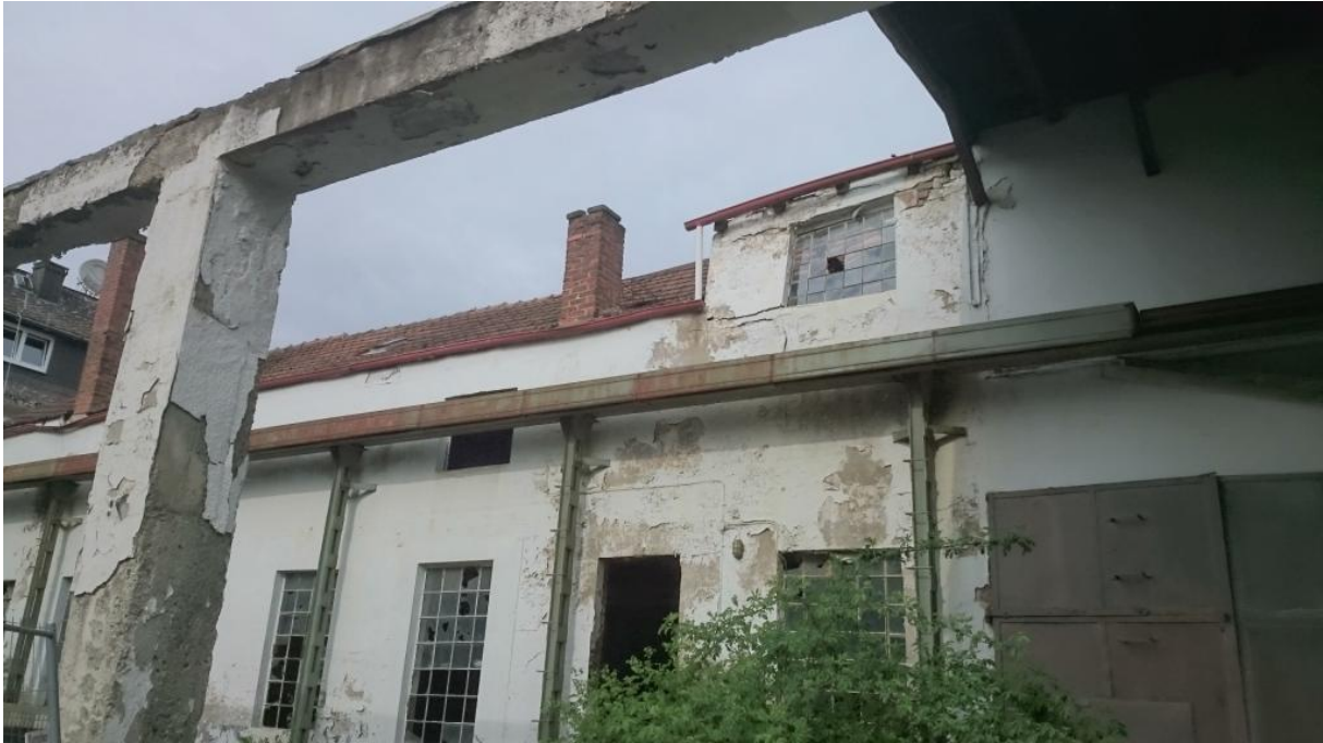
Abb. 18: Gebäude D, Außenansicht westl. Fassade mit abstehendem Ziegel rechts vom Schornstein
