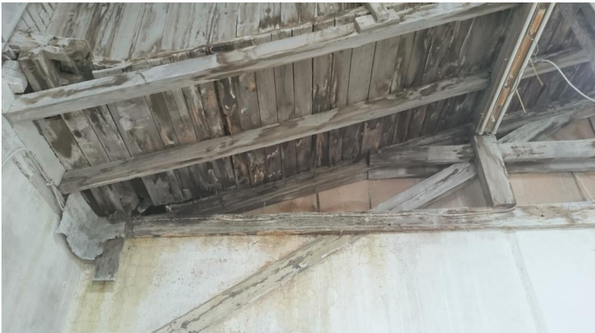
Abb. 17: Gebäude C: marode Dachkonstruktion mit zahlreichen Spalten und Hohlräumen
